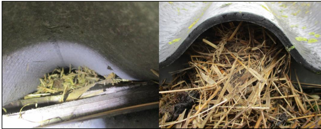
Figuur 3 Nestmateriaal van de huismus onder het golfplaten dak.
